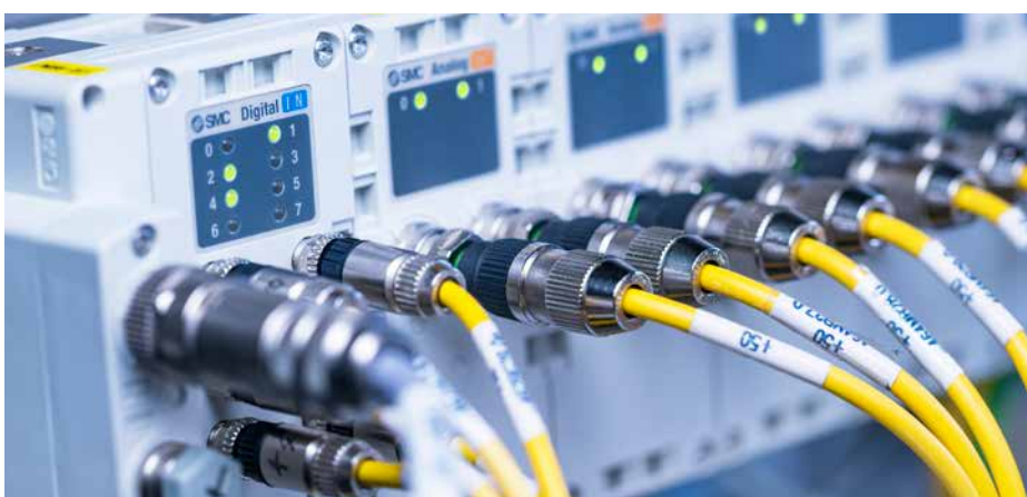
Optimale Steuerung: Die neue Schlauchbeutelmaschine FCB wird von einem SMC-Feldbussystem mit Profinet kontrolliert.
