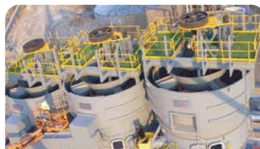
Celdas de Flotación
